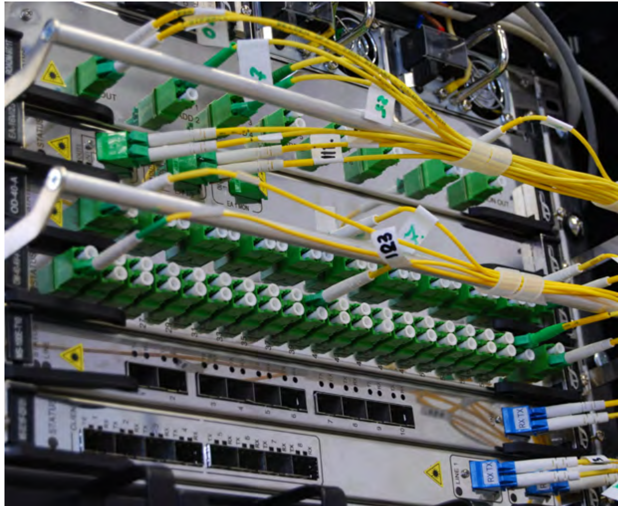
Equipement de télécommunication par fibre optique en rack ©Kirill Sh, Unsplash
