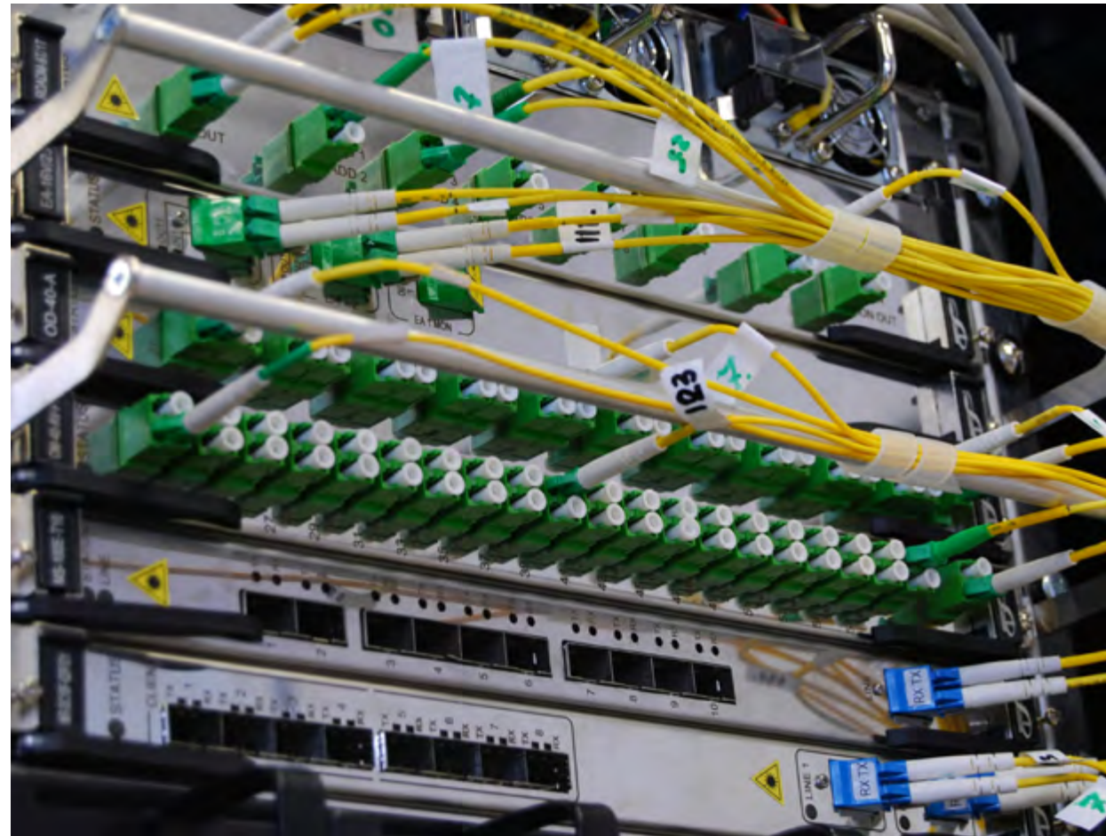
Glasfaser-Telekommunikationsausrüstung im Rack ©Kirill Sh, Unsplash
