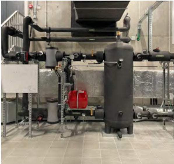
Courtrai Weide, un projet réseau de chaleur et de froid urbain en Belgique. ©Agata Smok
